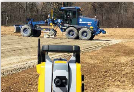
Der HBM-NOBAS Grader BG 120TA-6 wurde mit einer 3D – Tachymetersteuerung, einem 3-Wege-Kamerasystem und einem hydraulischem Scharseitenblech direkt zur aktuellen Baustelle von Schulz gebracht.
